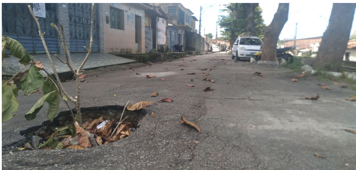
Buracos na rua Tobias Barreto
