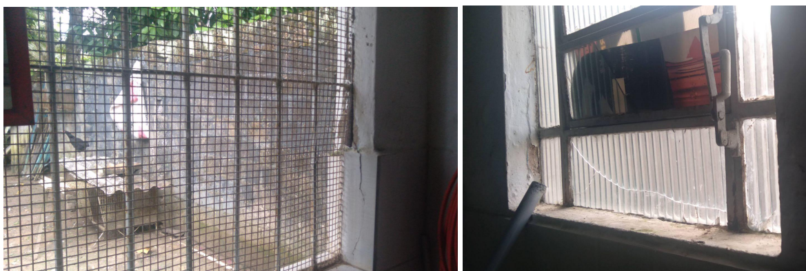
Rachaduras na casa de Seu Vicente, casa 741 na rua Tobias Barreto
