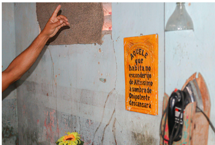
Fonte: fotos das relatoras. Morador com minadouro dentro da casa.
